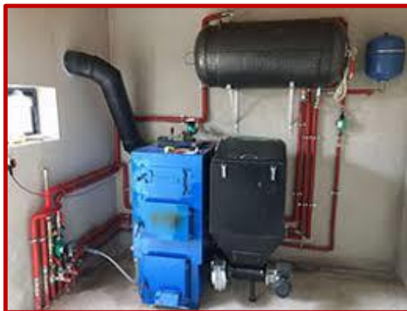
Typowe kotłownie z kotłem na węgiel, na drewno, na olej opałowy.
