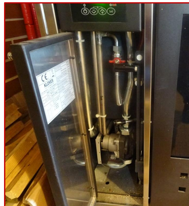
Komora z pompą obiegową c.o.
